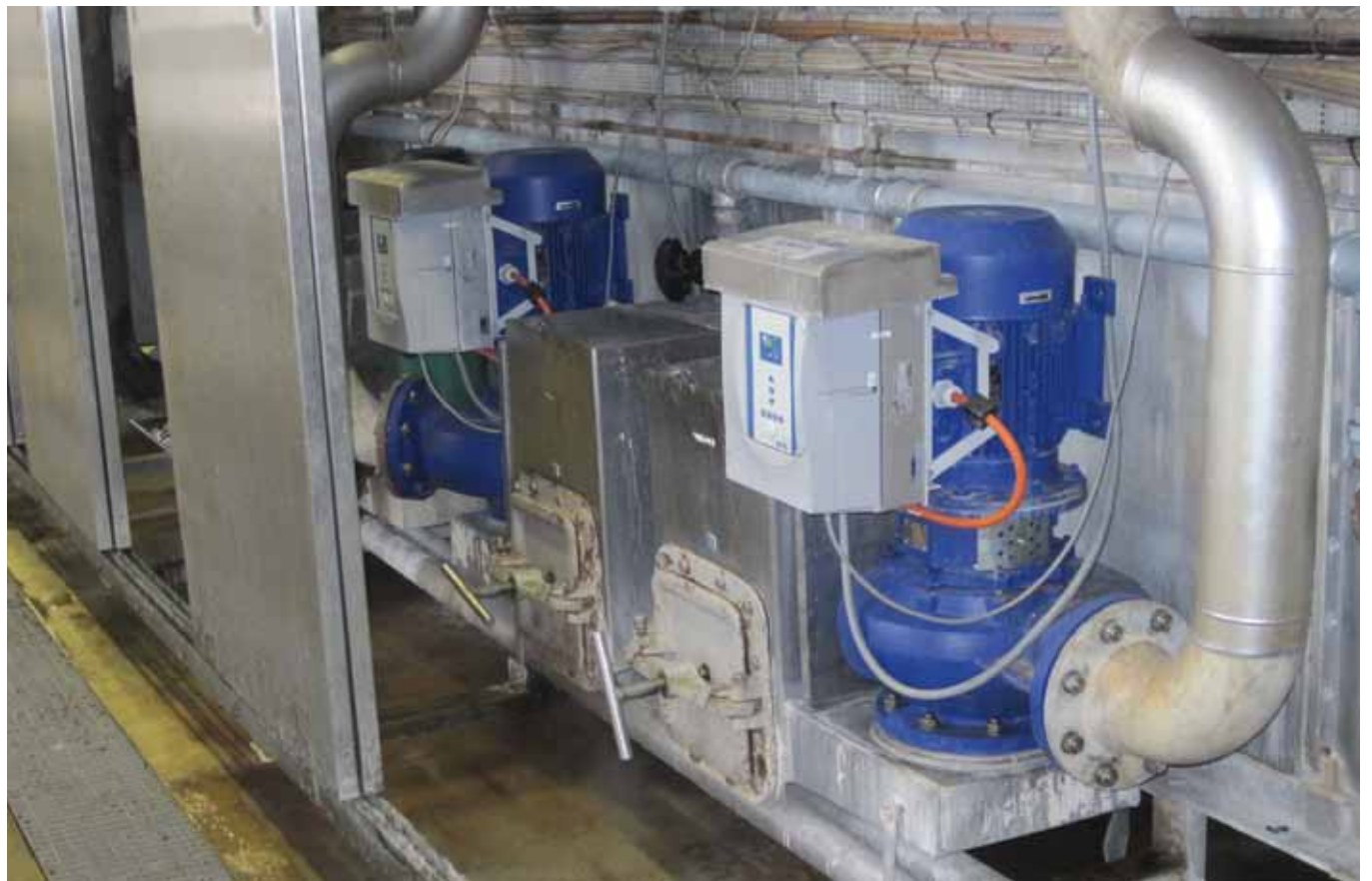
Albani bryggeriets tunnelpasteur med nye pumper påmonteret PumpDrive fra KSB, som regulerer pumpen efter det nødvendige forbrug
