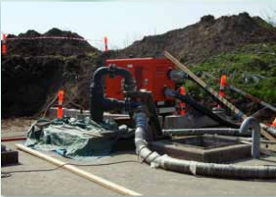
Beredskabspumpe installeret i forbindelse med renovering af en større pumpestation i Korsør
