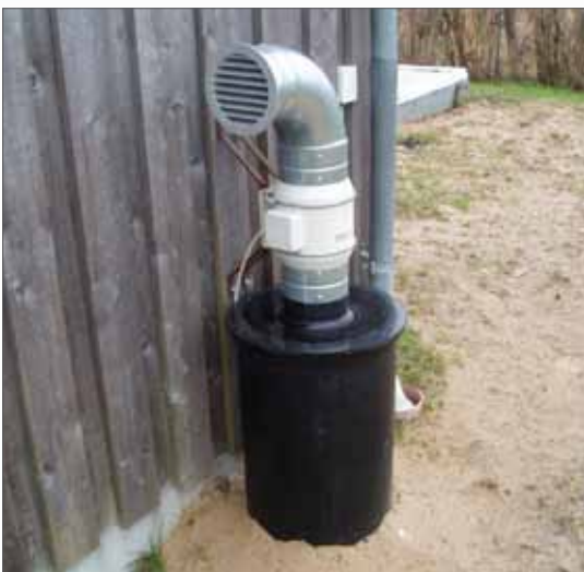
Lavafilter i funktion hos Dragør kommune
